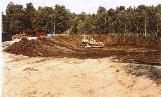
Av rotmassorna gjordes en sedimenteringsdamm på ca 5.000m 2 med 2 meter höga vallar
